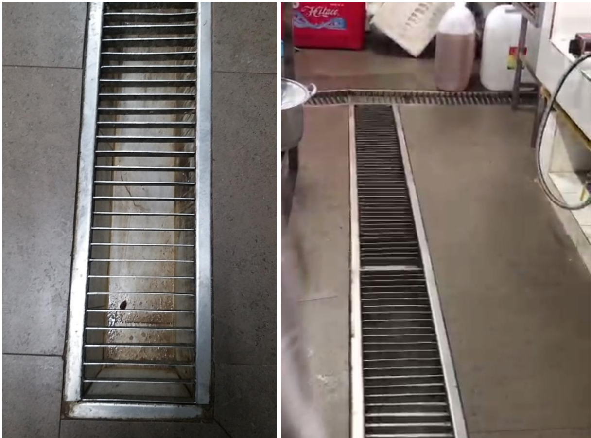
Hình 3.7. Rãnh thu gom nước thải từ sàn của khu bếp
