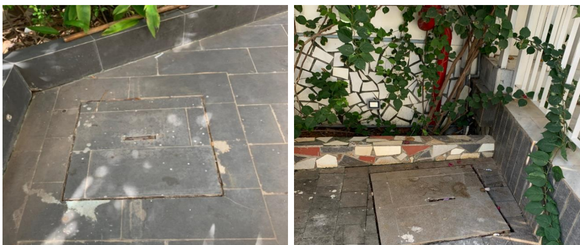
Hình 3.4. Hố ga thoát nước mưa tại cơ sở
