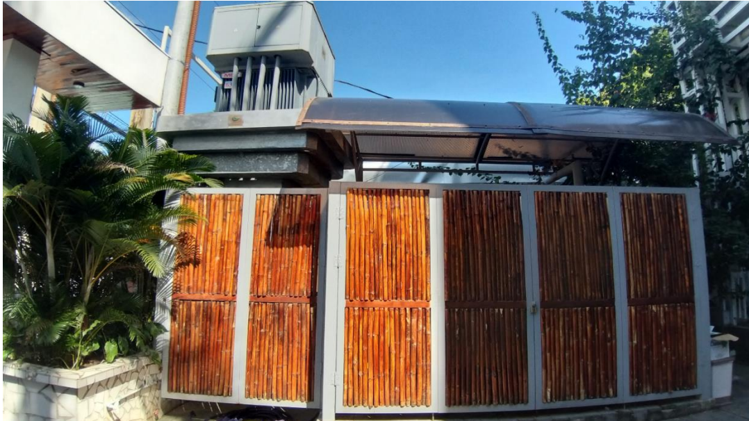
Hình 3.14. Khu vực đặt máy phát điện
