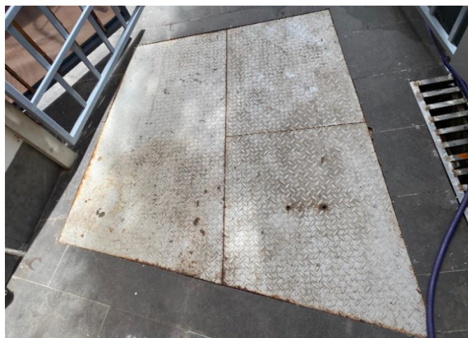
Hình 3.10. Bể tách dầu mỡ tại cơ sở
