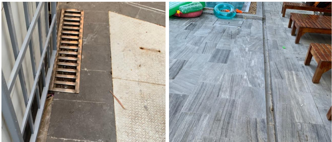
Hình 3.3. Rãnh thu nước mưa dọc theo các đường nội bộ
