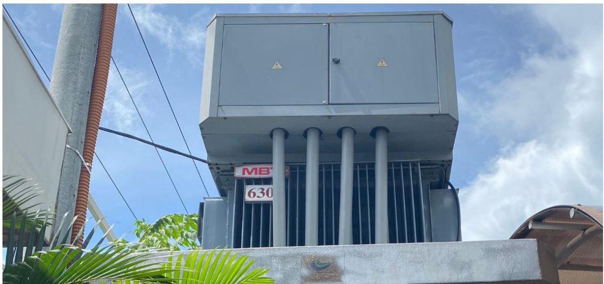
Hình 1.3. Trạm hạ thế tại cơ sở
